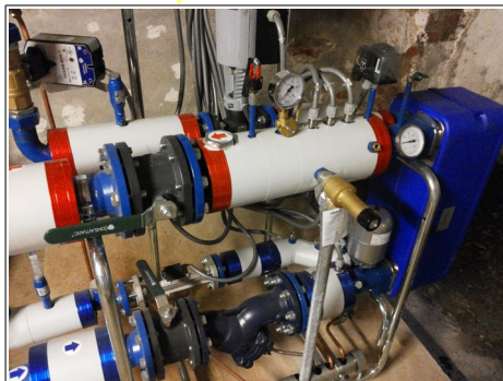
Scambiatore calore Teleriscaldamento
